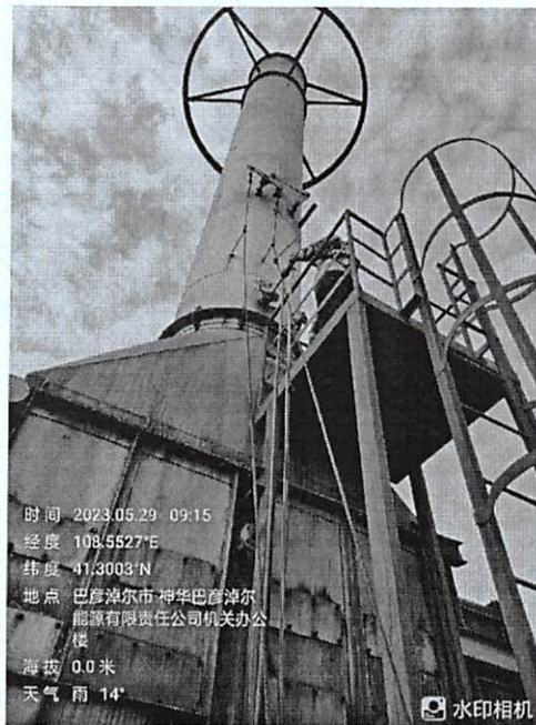
粗苯管式炉废气排气筒
