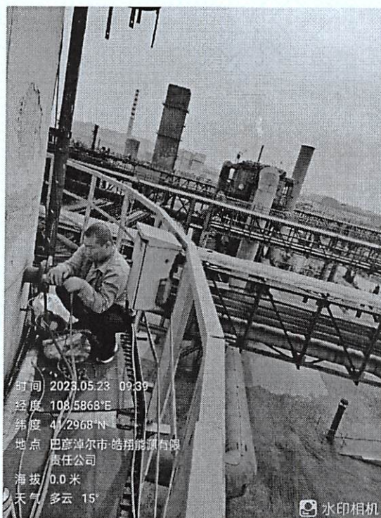
焦炉废气排气筒
